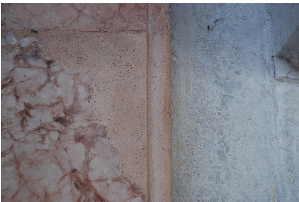
Particolari di alcune reintegrazioni con malte mimetiche-Paramento lapideo della facciata della chiesa di S. Francesco alla Fratta – LUCCA SEC. XIV.
